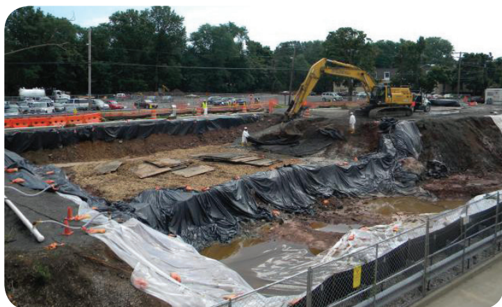
Durante la excavación, los montículos de tierra se tapan con lonas impermeabilizadas.
