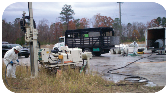
Inyección de un agente reductor en un hoyo perforado en el subsuelo.
