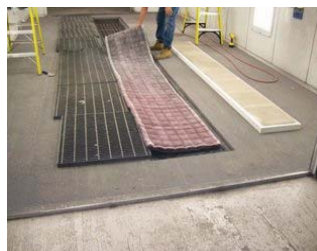
Piso de cabina con filtros sucios; Foto por Air Flow Technology,
